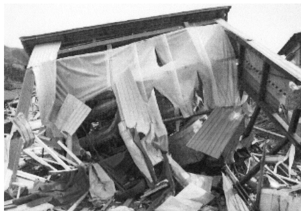
被災した山車保管庫 (平田青虎会提供)
