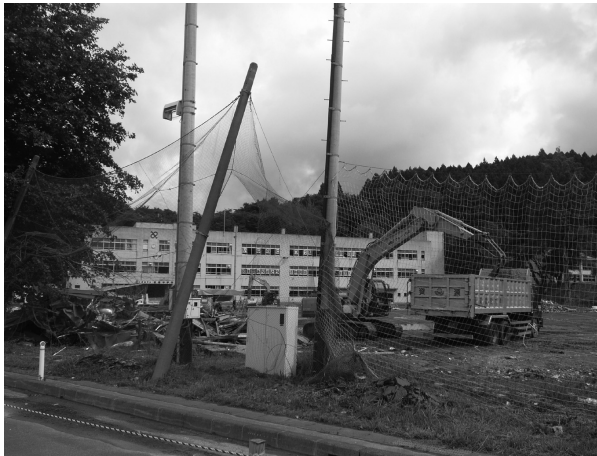
被災した赤崎小学校
