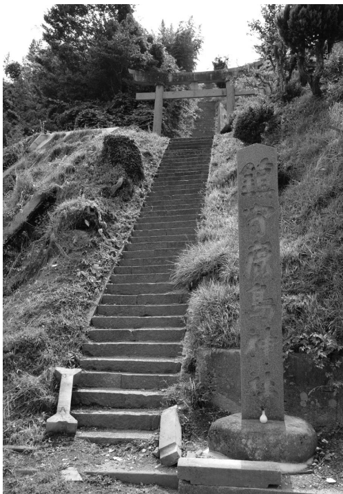
鹿島神社に登る被災した石段
