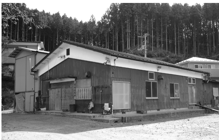
被災した大石公民館
