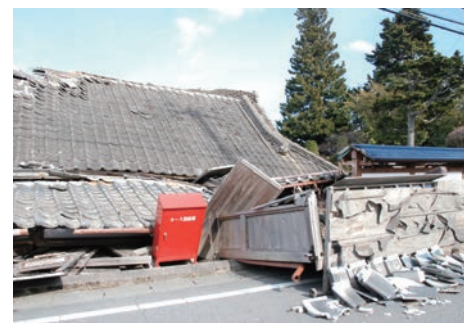
28 地震で倒壊した民家 双葉町 2012.3.20
