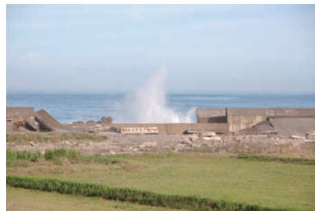
36 津波で壊れた防波堤 広野町 2012.8.4
